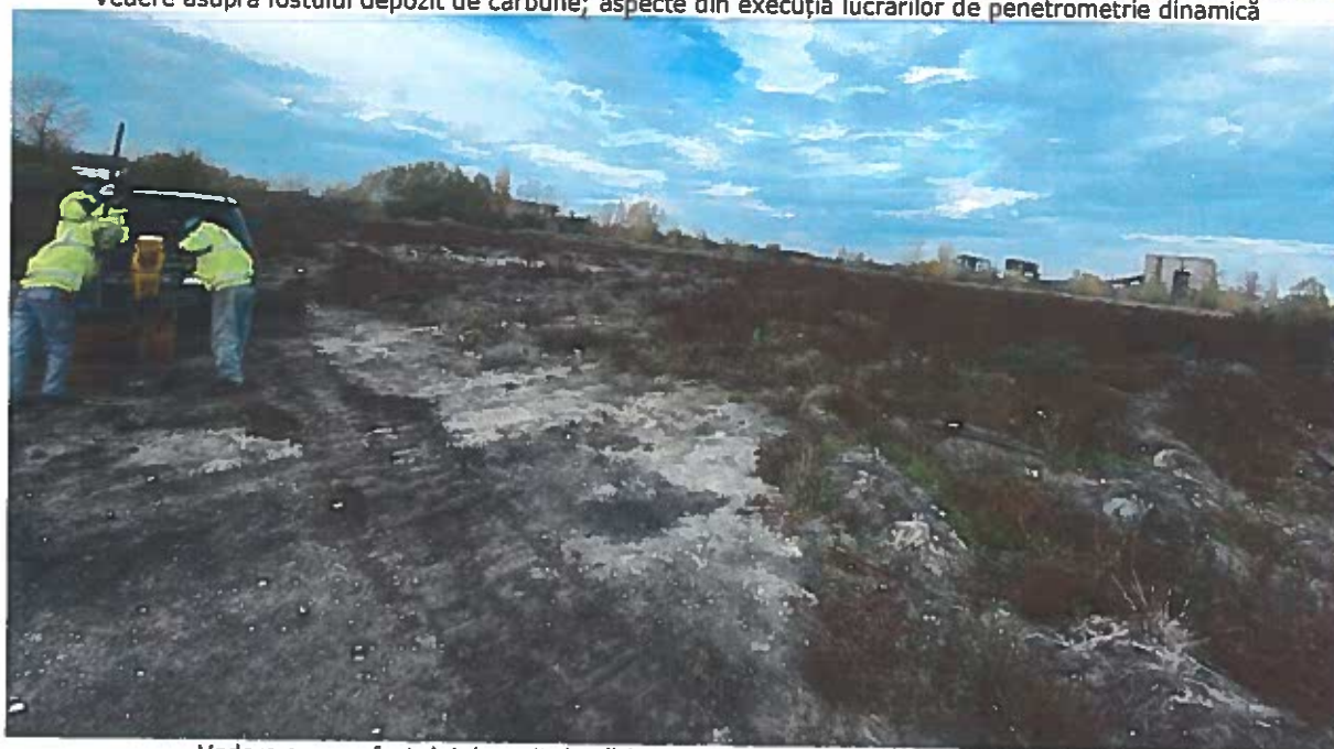
Vedere asupra fostului depozit de cărbune; aspecte din execuția lucrărilor de foraj
